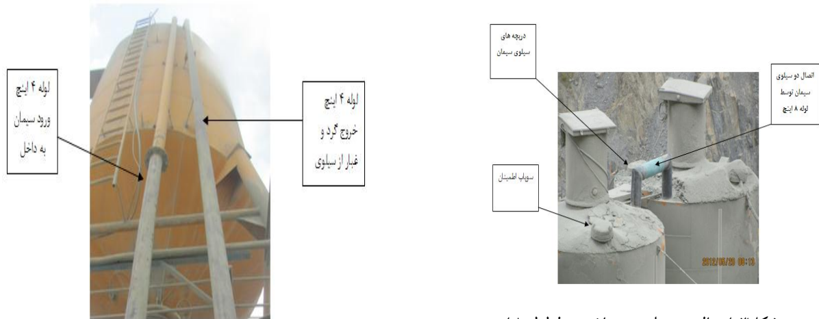
شکل ۳: اتصال دو سیلوی سیمان توسط لوله ۸ اینچ
