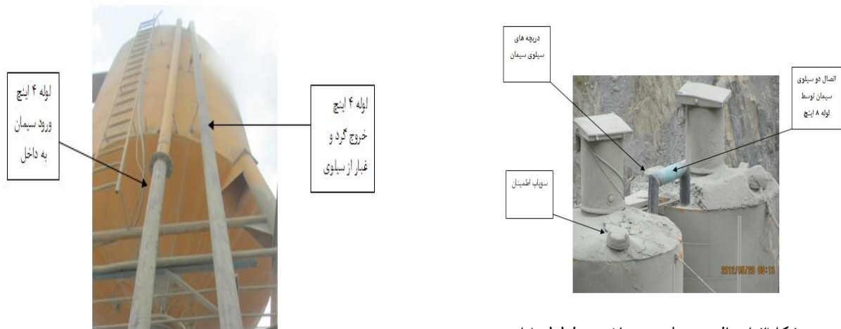
شکل ۳: اتصال دو سیلوی سیمان توسط لوله ۸ اینچ
